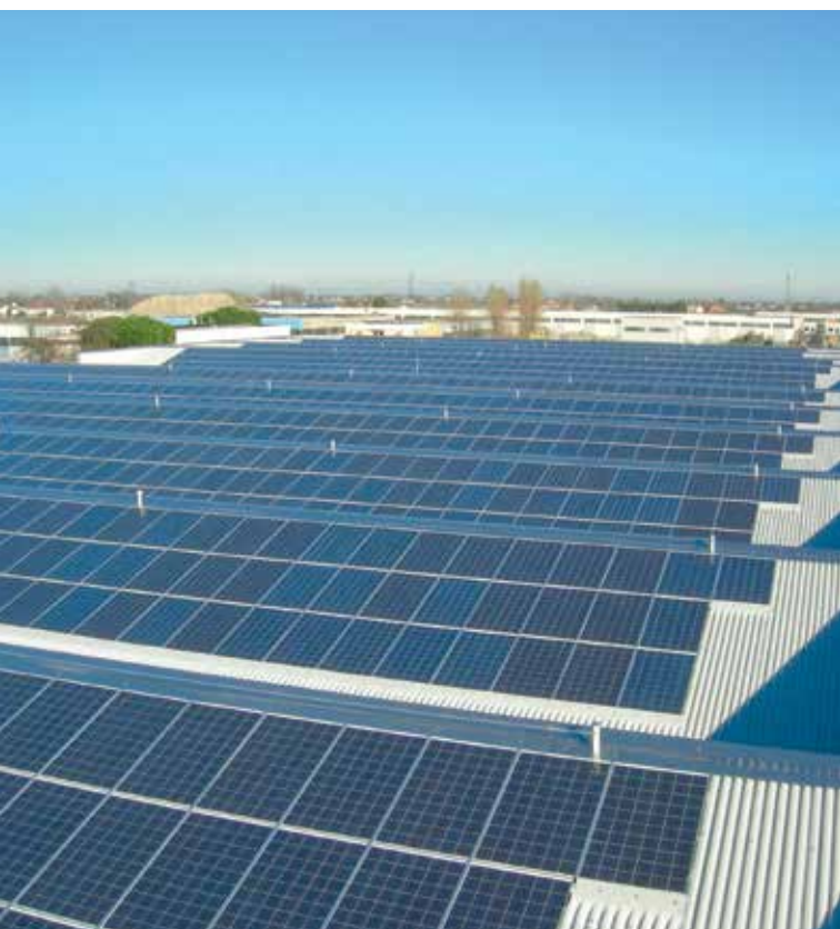
◀ Impianto fotovoltaico su copertura 1MW ▶
